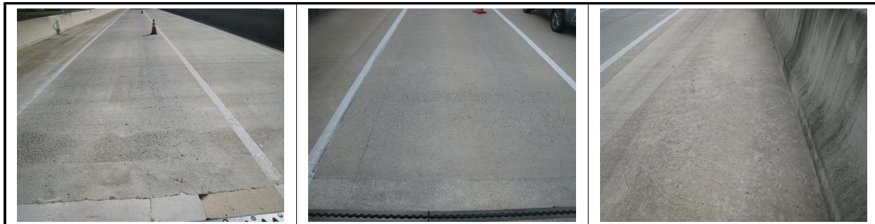
① 교면포장 망상균열 - 진전 여부확인, 추가 손상 발생여부 확인
