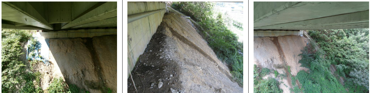
② 교대 A1측 법면 세굴 및 유실 - 진전 여부확인, 2차 손상 발생여부 확인
